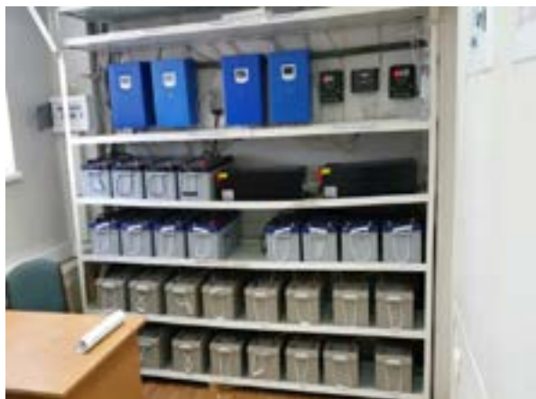
Рисунок 8 – Общий вид установки оборудования ветросолнечной электростанции
